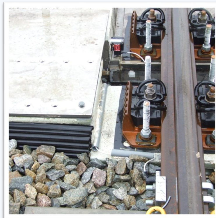
Snímač posunutí most – závěrná zídka mostní opěry
