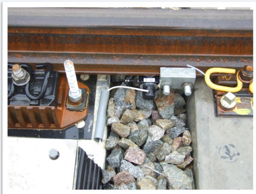
Snímač posunutí kolejnice - pražec
