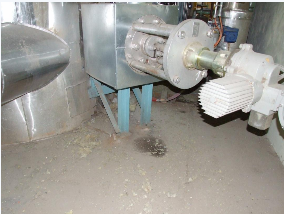
Výrazné kmitání armatur - poškození izolací
